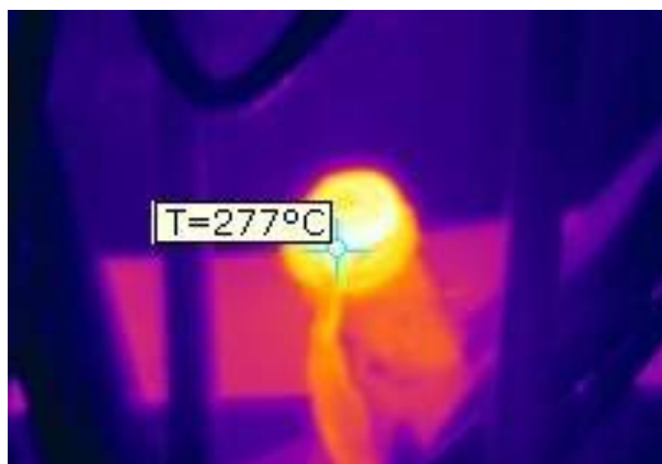
Рисунок 22. Пример обнаружения пожароопасного разогрева болтового контактного соединения
