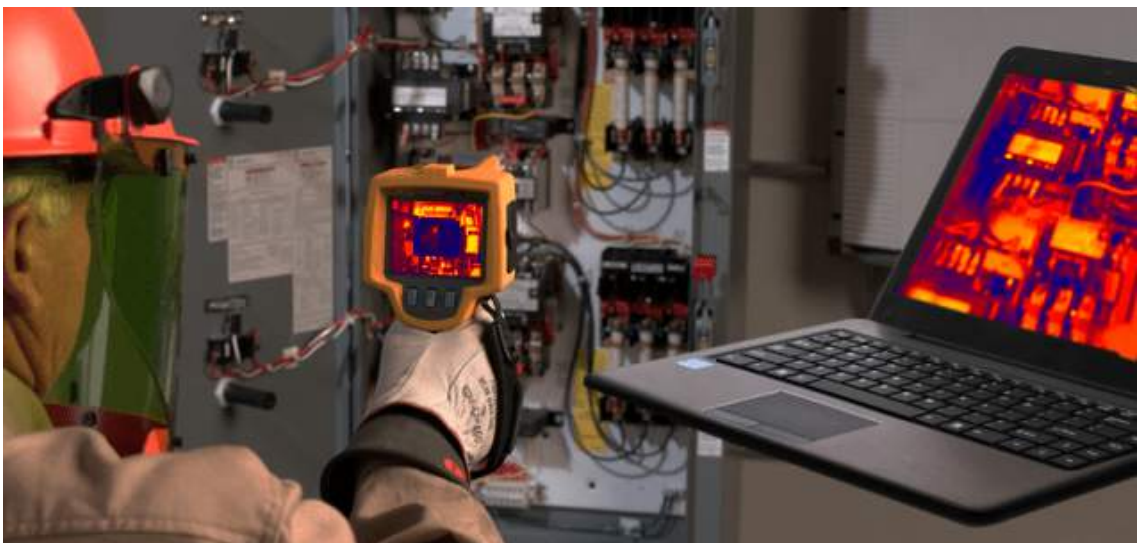
Рисунок 20. Пример проведения тепловизионного контроля электрошкафа
